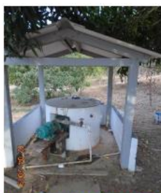
Fotografía 18 Pozo de agua profundo Fuente: E.T.S.A. S.A.S. 2019
